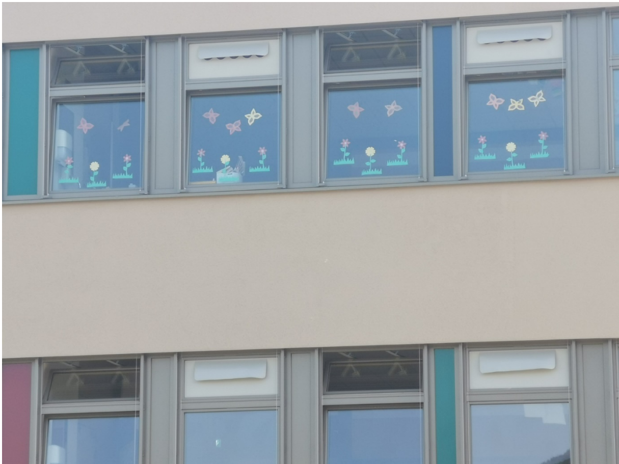
Fassadenansicht des G2: In den Klassenzimmern der Schillerschule wurden in Fensterelementen bereits Lüfter integriert.
