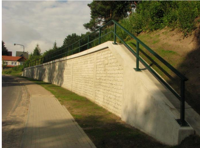
Abbildung 5.4: Beispiel für eine Absturzsicherung an einer Stützwand
