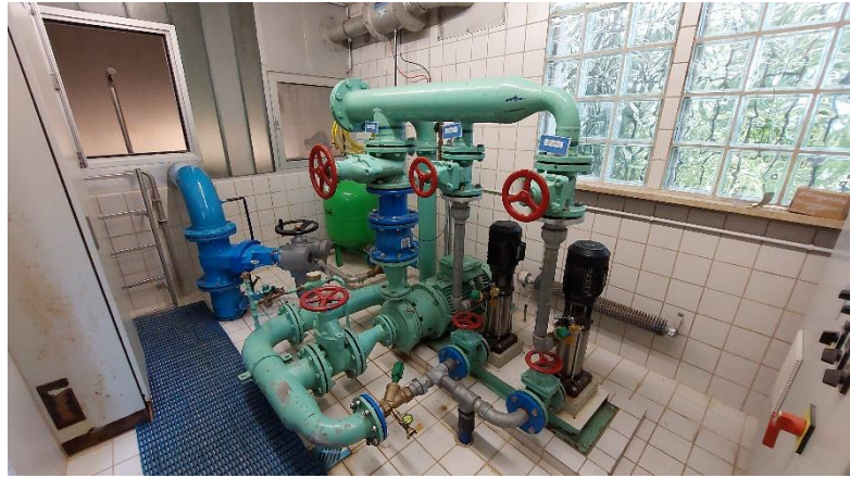
Abbildung 1.3: Innenansicht mit Blick auf den Eingang zur Wasserkammer und der Druckerhöhungsanlage Ackerloch/Königshöhe
