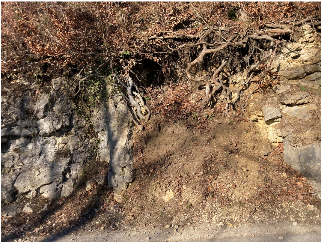
15.02.2023 – freiliegendes Wurzelwerk infolge Ausspülungen
