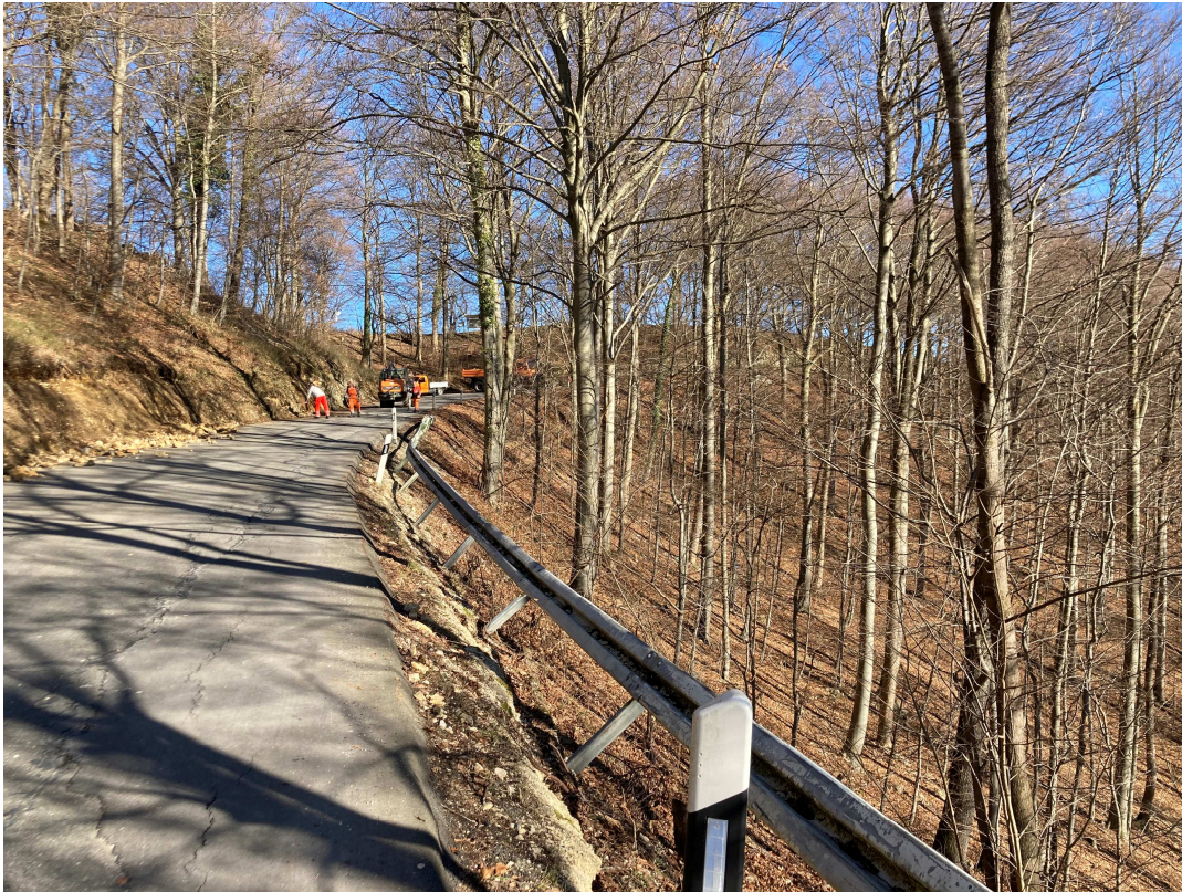
15.02.2023 – abschüssige Fahrbahnbeläge, desolante Bankette, abgerutschte Schutzplanken
