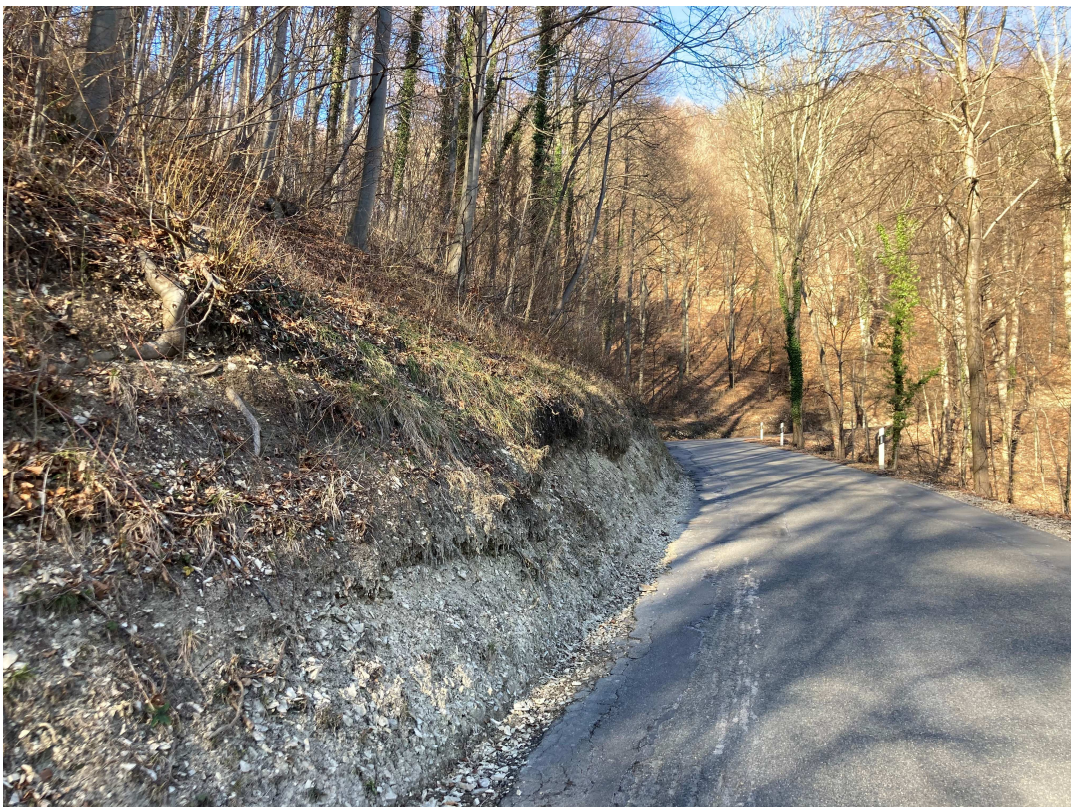
15.02.2023 – freiliegender, der Witterung ausgesetzter Fels - hier mit schwach ausgeprägter Auffangmulde am Böschungsfuß für loses Hangschuttmaterial
