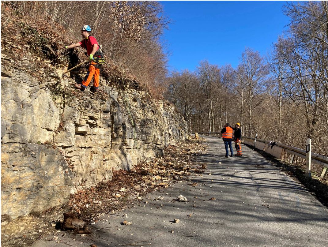
15.02.2023 – Felsberäumungsarbeiten, abschüssige Fahrbahnbeläge, desolante Bankette
