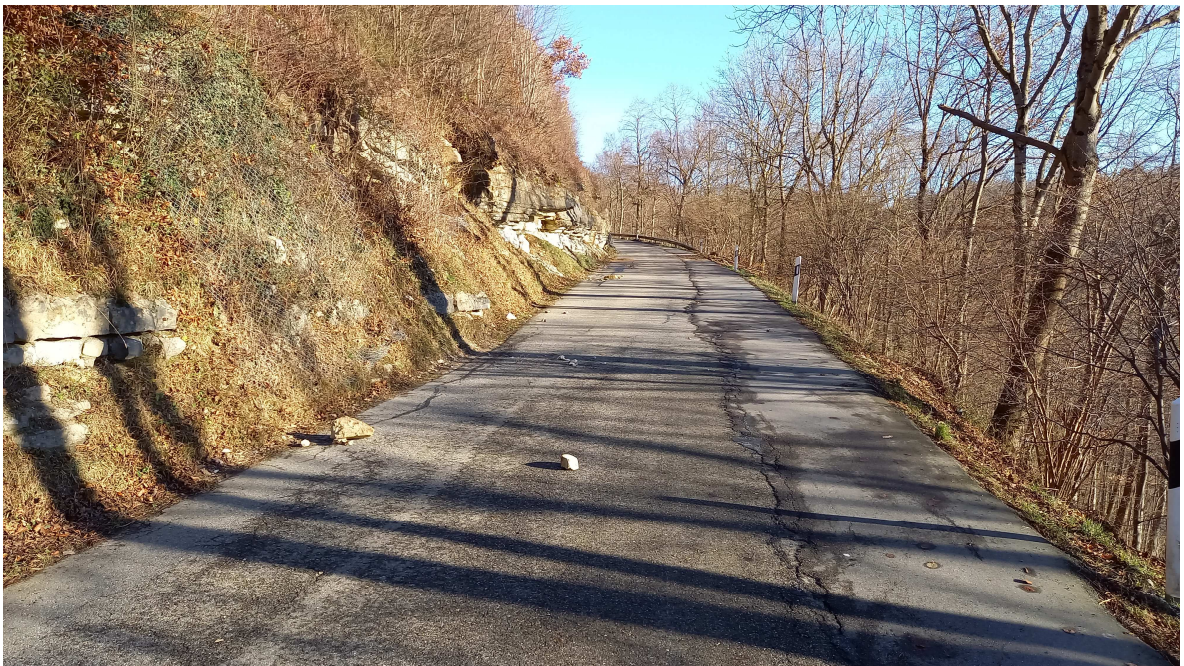
25.12.2022 – Steinschlag, abschüssige Fahrbahnbeläge, desolate Bankette
