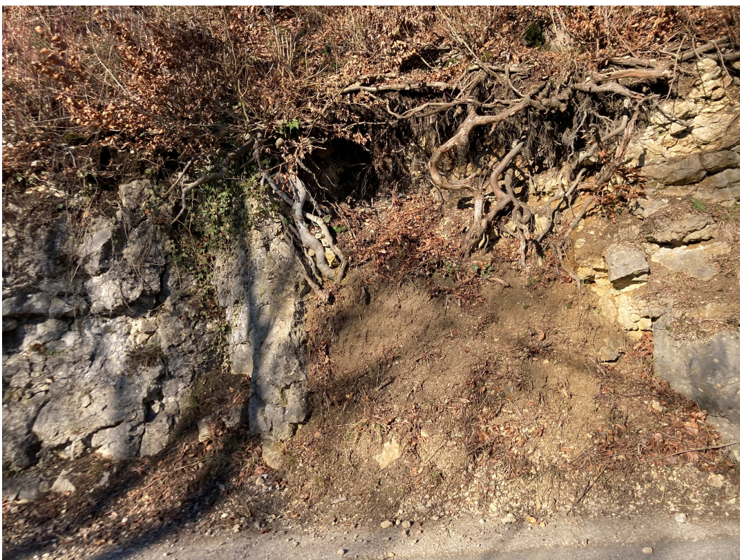
15.02.2023 – freiliegendes Wurzelwerk infolge Ausspülungen
