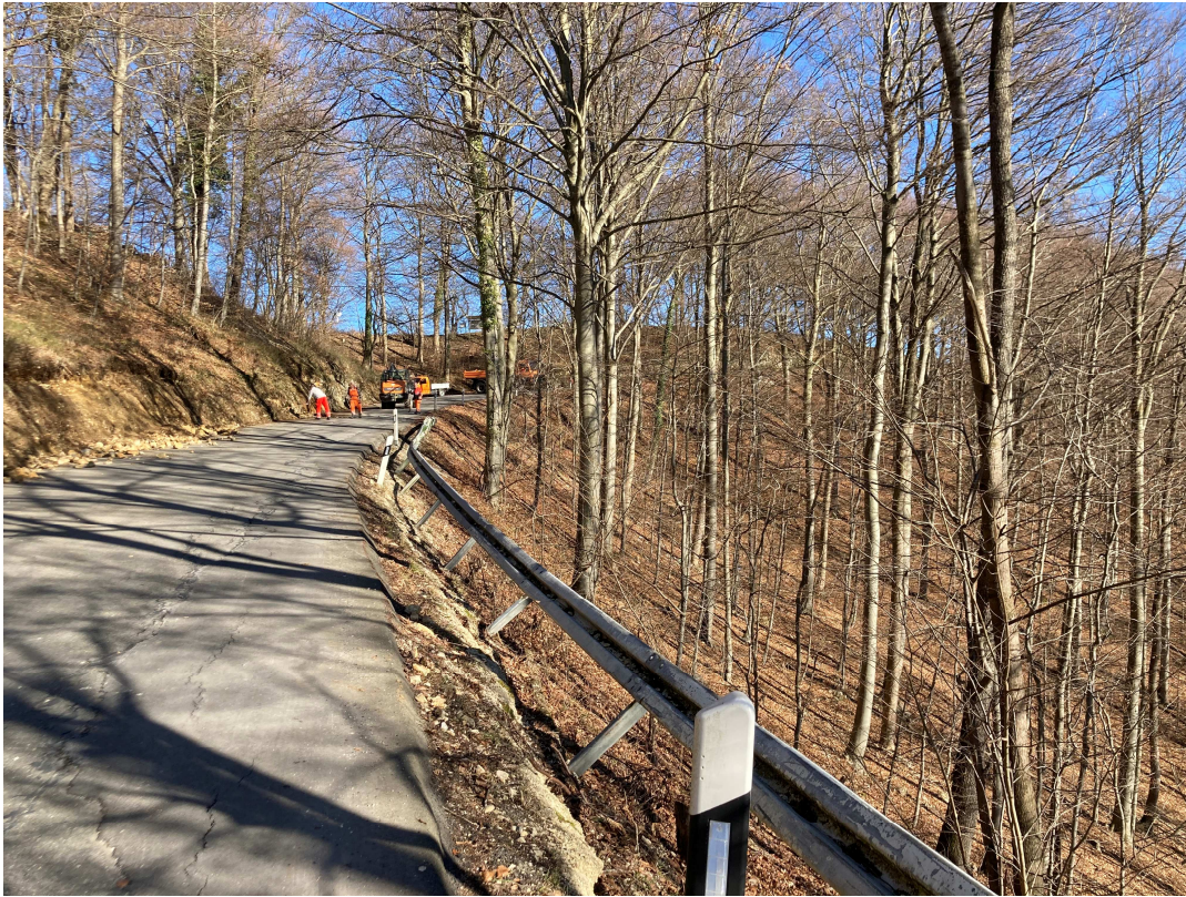
15.02.2023 – abschüssige Fahrbahnbeläge, desolante Bankette, abgerutschte Schutzplanken
