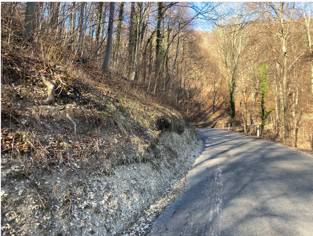
15.02.2023 – freiliegender, der Witterung ausgesetzter Fels - hier mit schwach ausgeprägter Auffangmulde am Böschungsfuß für loses Hangschuttmateriale
