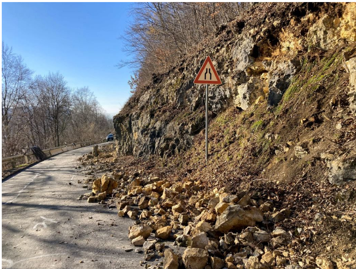
Kontrollierte, manuelle Felsberäumung des Oberhanges 2022
