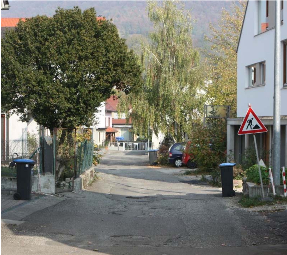
Schadhafter Straßenbelag im Mühlgässle: Dieser wäre unter anderem Priorität 1 im Rahmen der Gestaltung von Straßen und Plätzen als Teil des Aufstockungsantrags.
