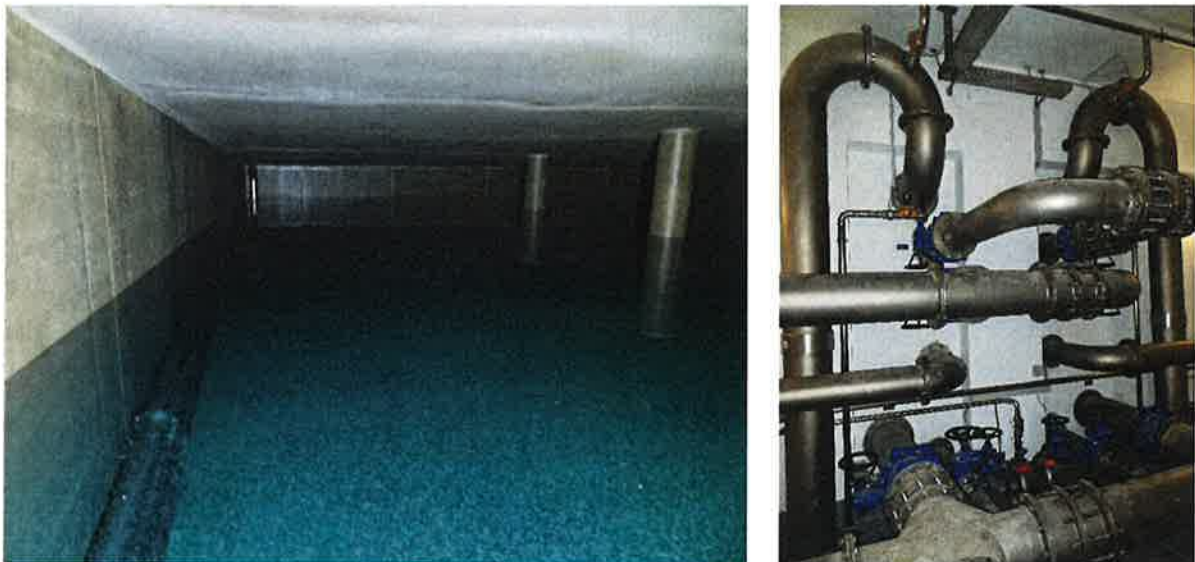
Abbildung 2-3: Behälterkammer und Detail hydraulische Installation
