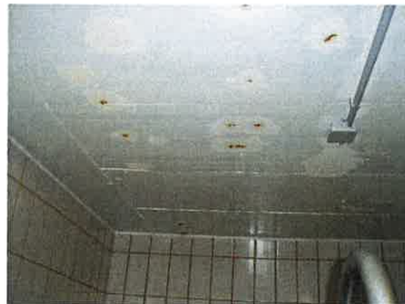
Abbildung 3-8: Korrosionsschäden im Deckenbereich
