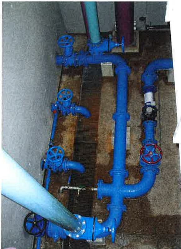
Abbildung 3-11: Hydraulische Installation, Entnahmeleitungen, Grundablässe
