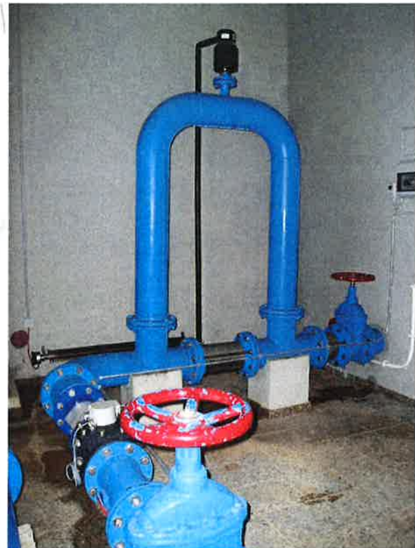
Abbildung 3-12: Brandbrücke in Entnahmeleitung
